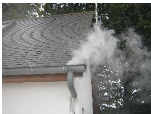
Descente de toit mal raccordée
